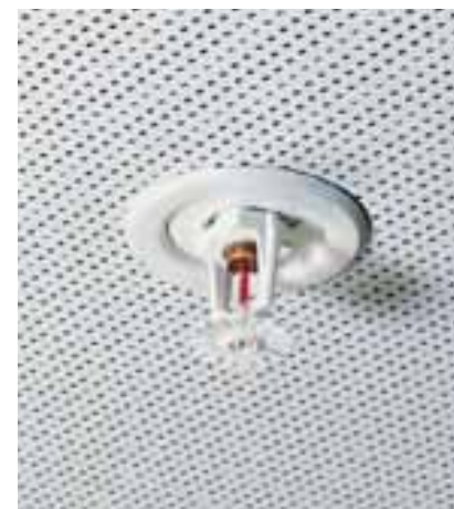
▲ Головка спринклера, установленная в вырезанном круглом отверстии
